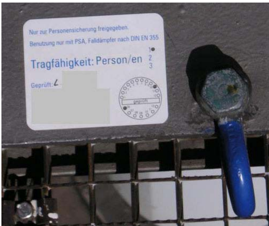
Bild 14: Beispiel für die Kennzeichnung der Sachkundigenprüfung an einer permanenten Anschlagseinrichtung, Quelle: DFMG
